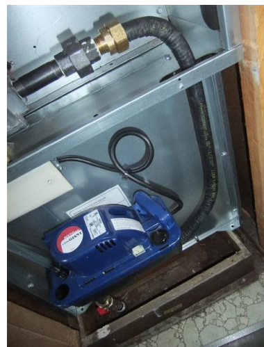
Bombas de condensado: Estas pequeñas bombas se instalan en el gabinete de la caldera.
